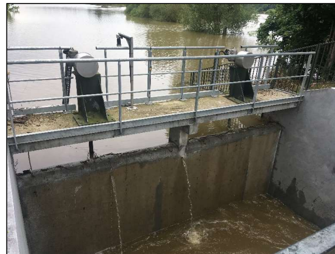
Crue juin 2018 relevés terrain
