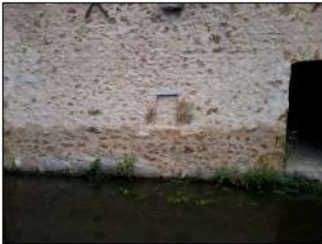
Laisses de crue sur le bassin de l'Yvette en juin 2016
