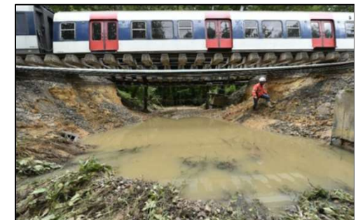
Effondrement talus du RER C
